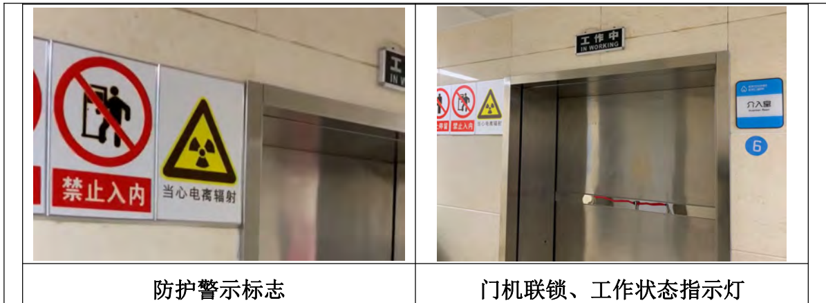
图3-1 介入手术室DSA机房入口处防护门
